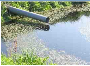
le tuyau d'arrivée dans la première lagune
