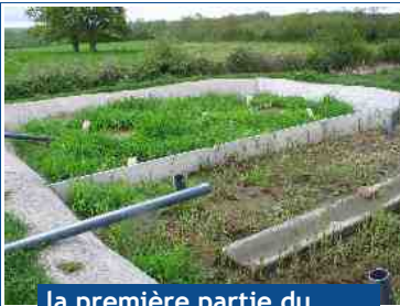
la première partie du filtre (filtrage vertical)
