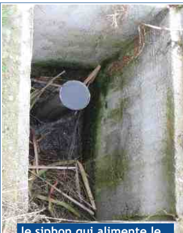
le siphon qui alimente le fossé d'infiltration
