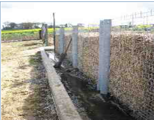
Le caniveau de récupération des eaux avant envoi dans la lagune
