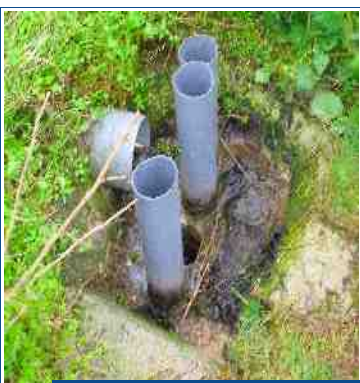
le répartiteur à tuyaux coulissants
