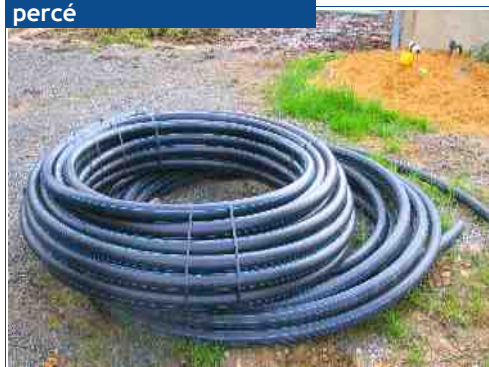
les 100 mètres de tuyau percé
